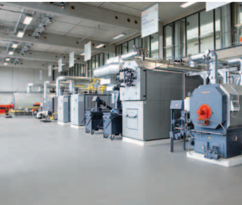
Energetická centrála v sídle firmy v Allendorfe (Eder)
