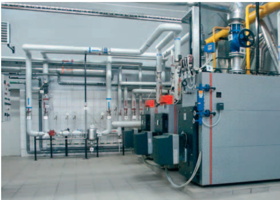
Zariadenie s nízkotlakým parným kotlom Vitoplex 100-LS ako aj dvomi teplovodnými kotlami Vitoplex
