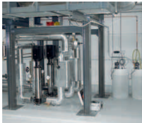
Čerpadlá napájacej vody
