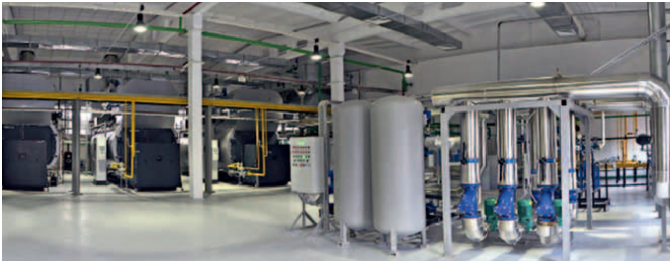
Energocentrála s kotlami Vitomax. Tieto kotly sú už schopné 100 % prevádzky na vodík.
